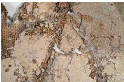
Fig. 4A – Particolare delle efflorescenze saline sulla pellicola pittorica.
