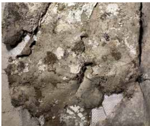
Fig. 3A – Particolare della colonizzazione biologica estesa su tutta la superficie dell'opera.
