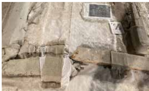
Fig. 8. Particolare, frattura del telaio.
