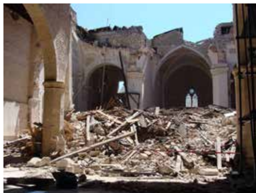
Fig. 5. I danni strutturali subiti dalla Basilica di Collemaggio a seguito del sisma del 6 aprile 2009. (foto SABAP-AQ-TE)
